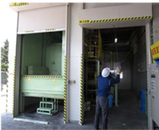
専用の破碎設備および破碎が必要な発生品の保管庫
