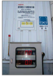
原料槽ガス濃度表示器
