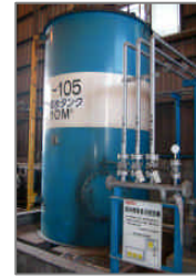
原料槽緊急冷却設備
