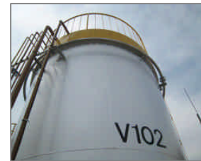
原料タンクの冷却設備
