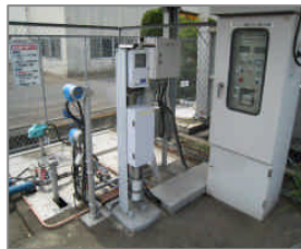
雨水などの排水監視所
