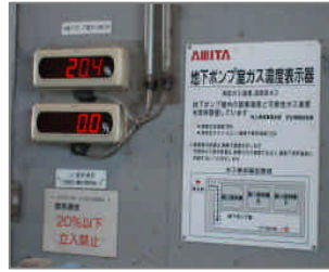
地下ポンプ室ガス濃度表示器
